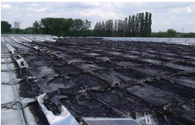
Вид крыши после повреждения
